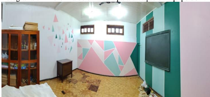
Fotografia 7 – Reforma de uma sala para atuação da equipe do NEPRE da Escola 4
